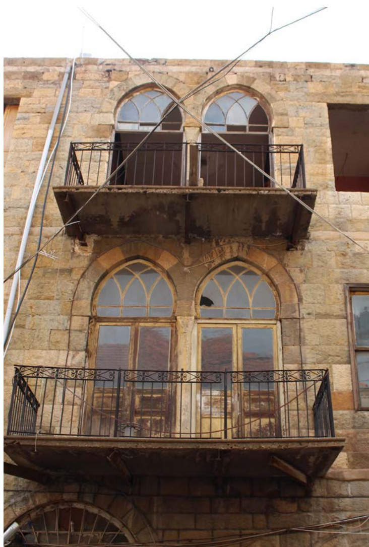
Fig. 16. Exemple d'un bâtiment dégradé
