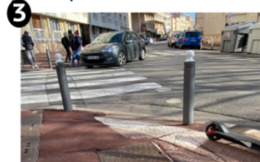
3 Bande podotactile obsolète 1 1
